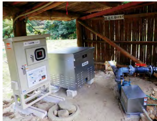
ポンプを利用した発電設備
